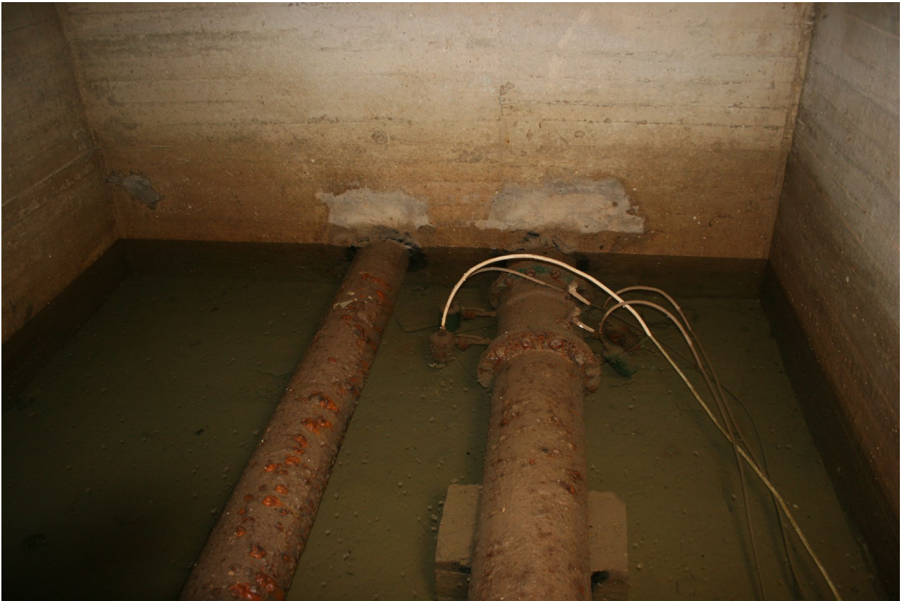
Camera di manovra presa n. 17
