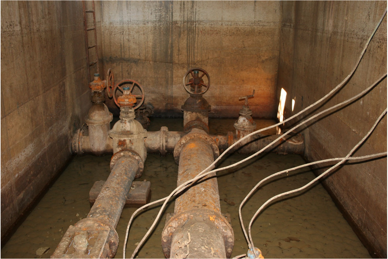
Camera di manovra presa n. 13-14
