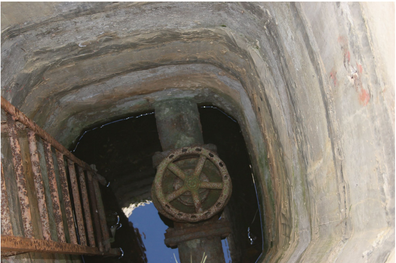
Vasca di disconnessione 5 - Camera di manovra
