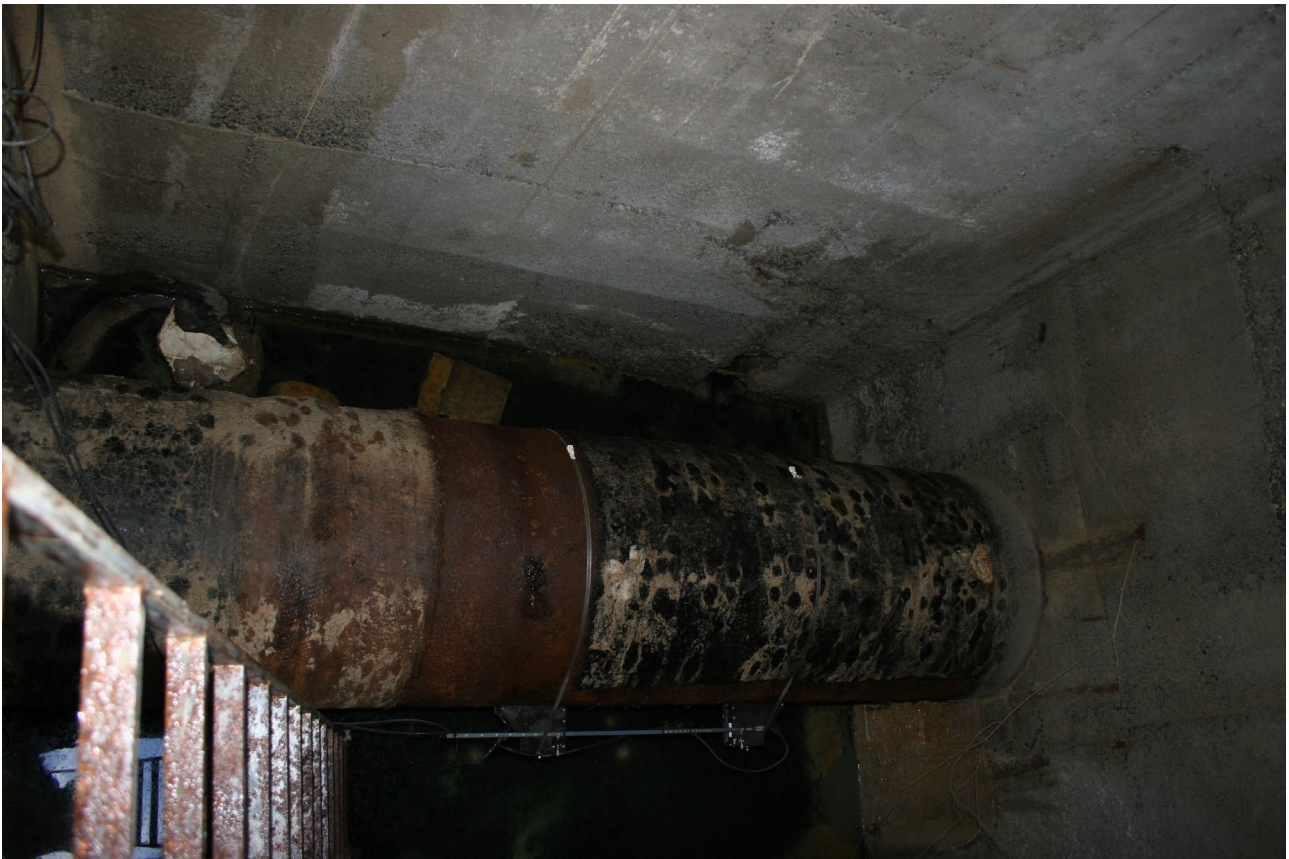
Vasca di disconnessione Zero – Camera di manovra 2
