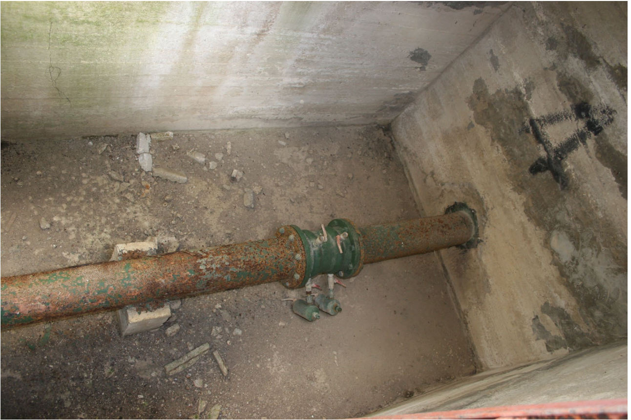
Camera di manovra presa n. 4
