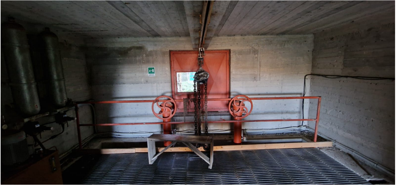
Camera di manovra presa diga Ragoletto - Foto n. 5
