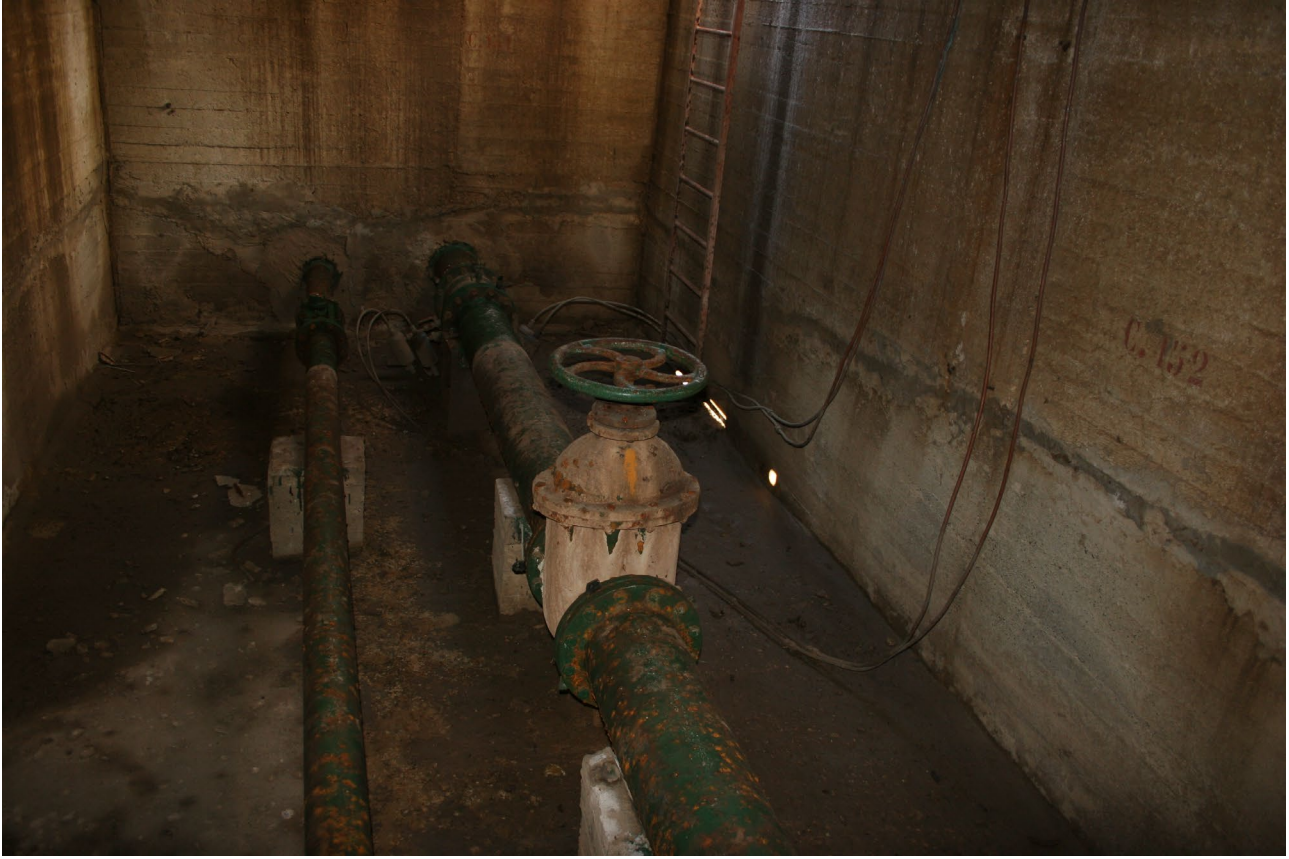
Camera di manovra presa n. 15
