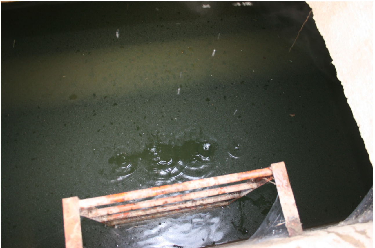
Camera di manovra presa n. 19-19-bis-20
