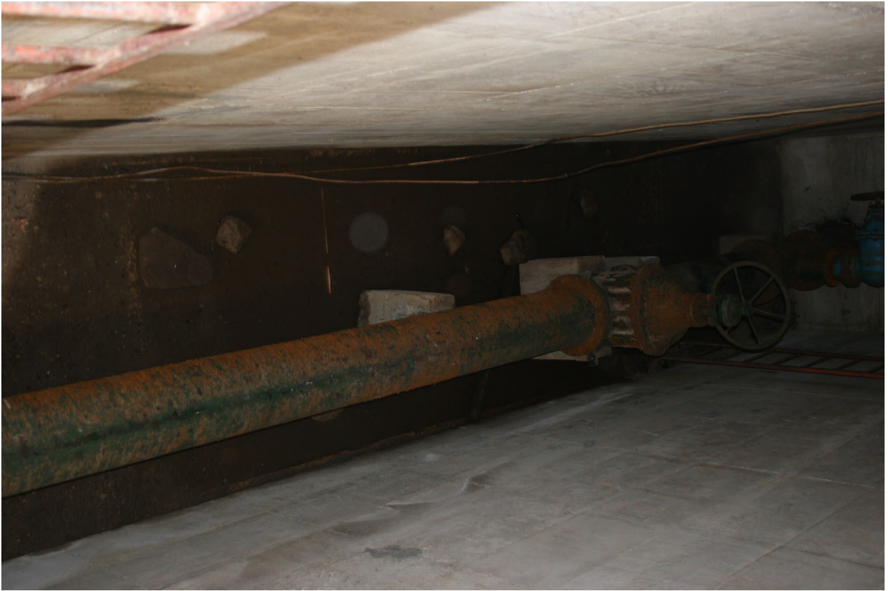
Camera di manovra presa n. 6
