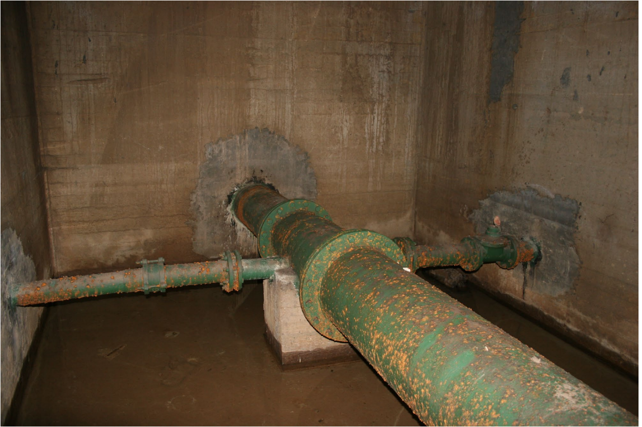
Camera di manovra presa n. 8-9
