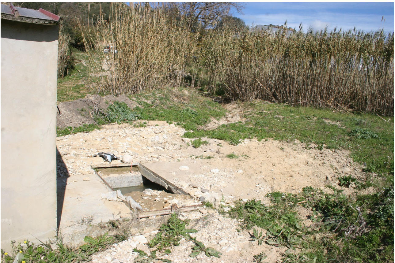
Camera di manovra presa n. 5
