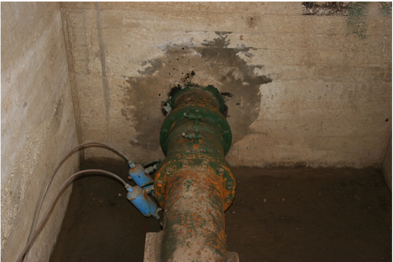
Camera di manovra presa n. 16
