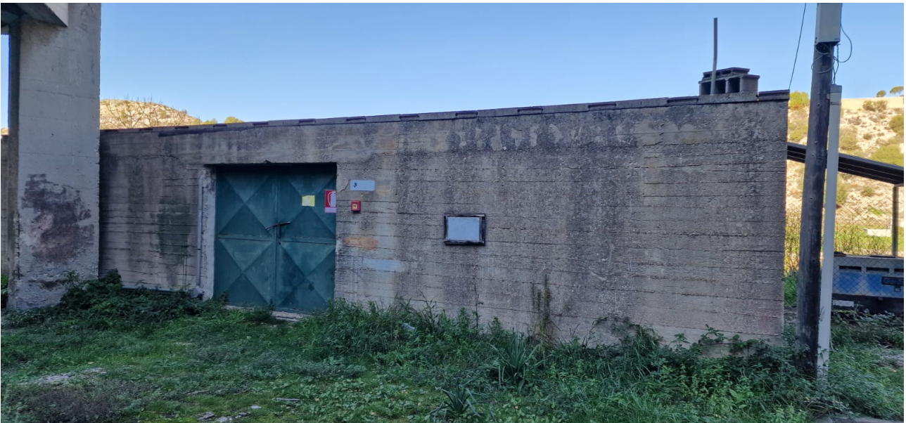
Camera di manovra presa diga Ragoletto - Foto n. 2
