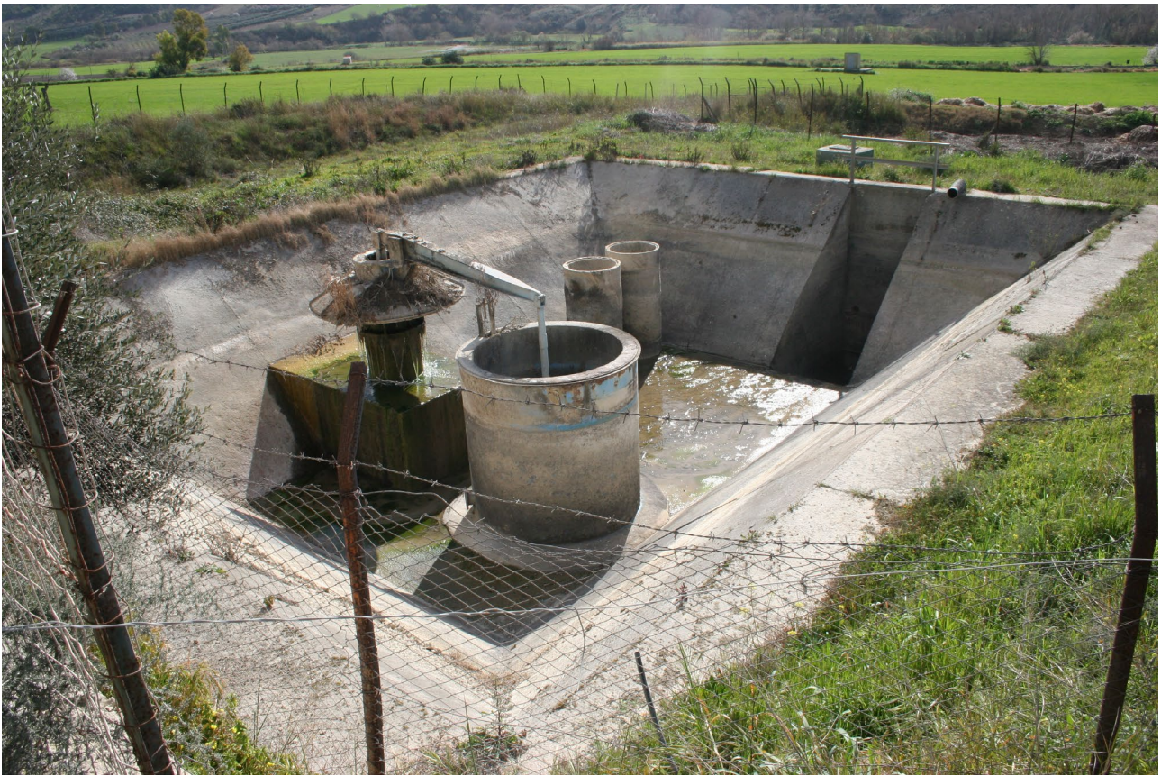
Vasca di disconnessione 1
