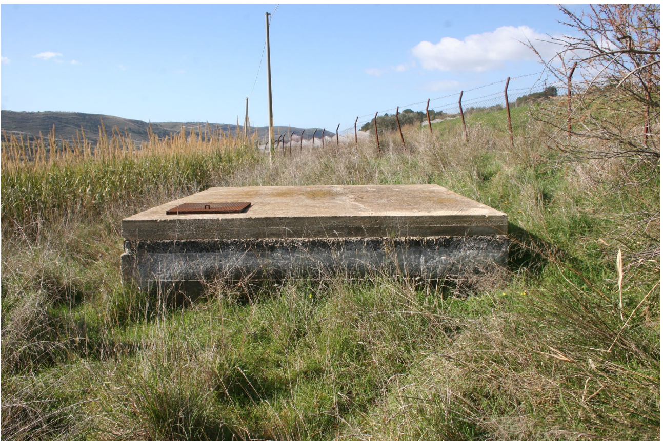
Vasca di disconnessione Zero - Camera di manovra 2
