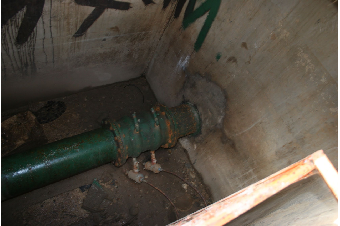
Camera di manovra presa n. 7
