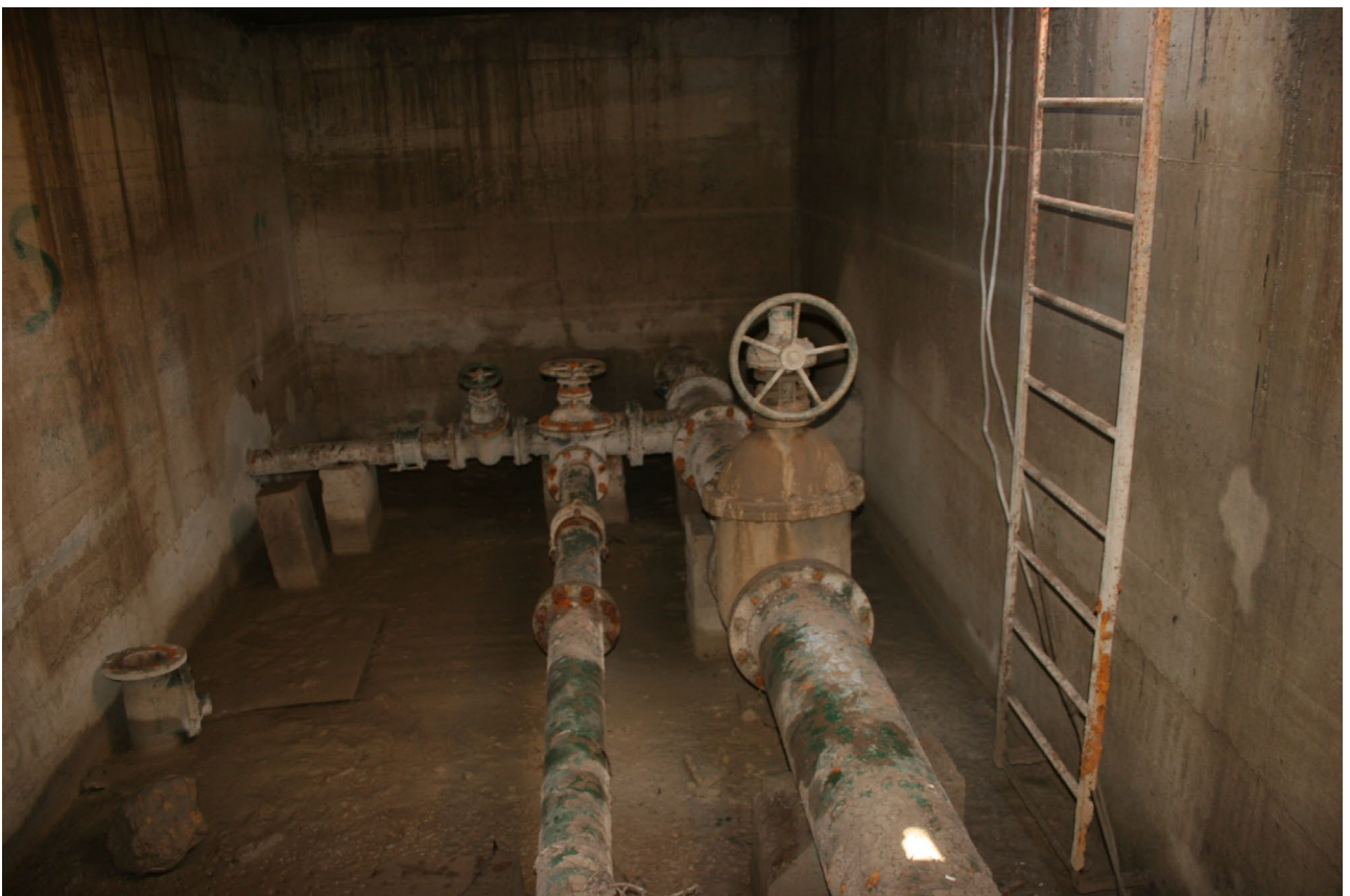
Camera di manovra presa n. 14 bis
