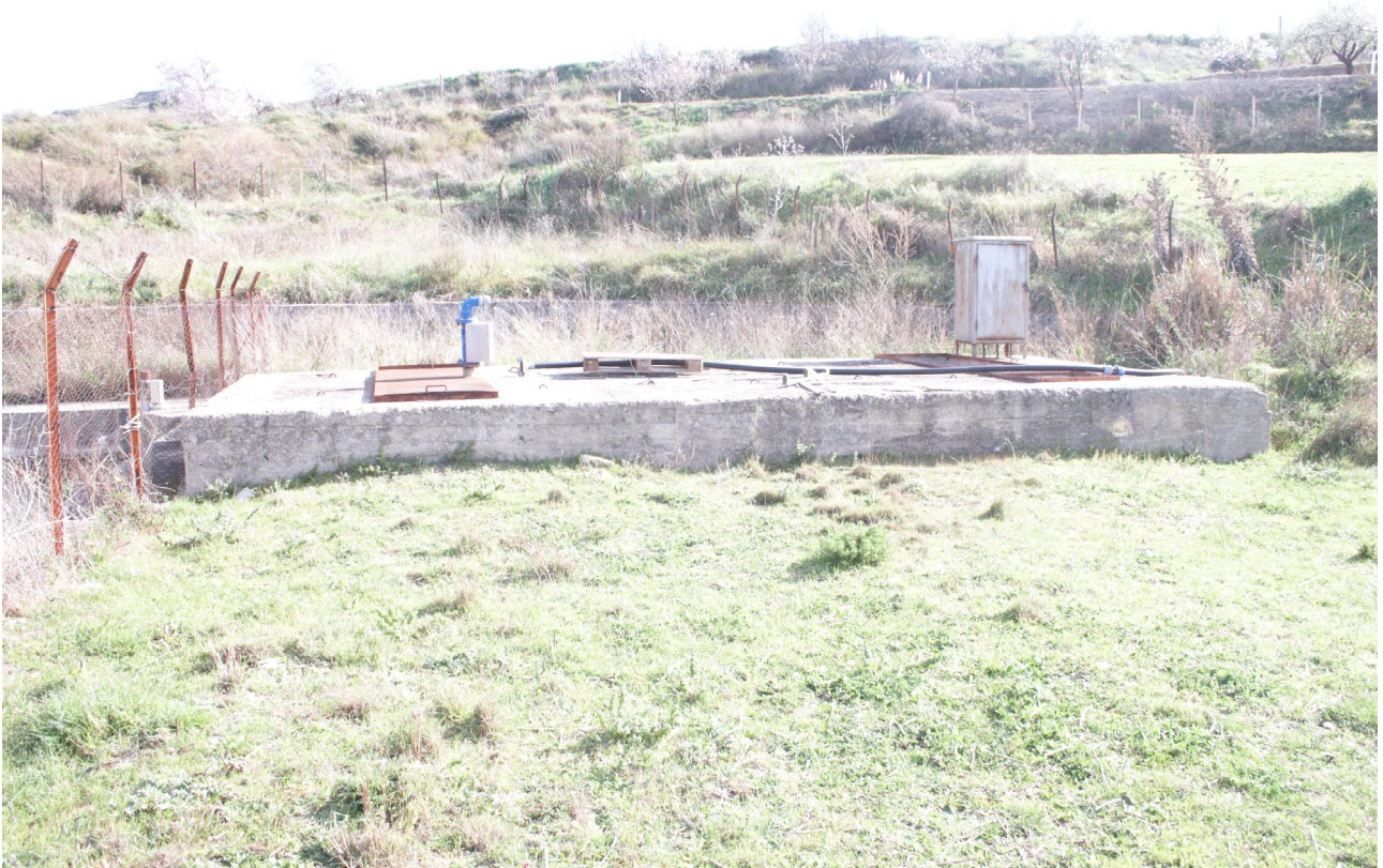
Vasca di disconnessione Zero - Camera di manovra 0
