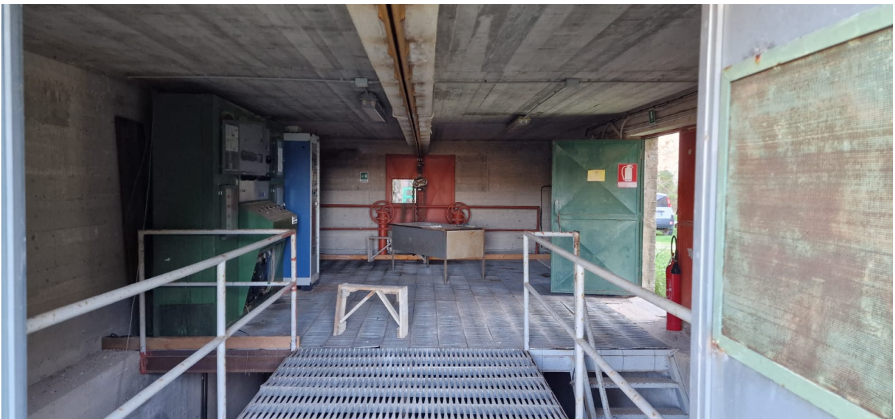
Camera di manovra presa diga Ragoletto - Foto n. 4
