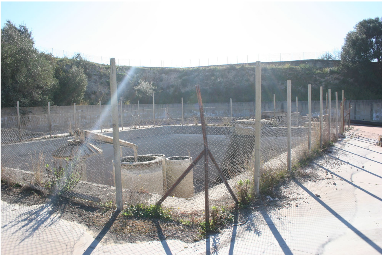
Vasca di disconnessione 3
