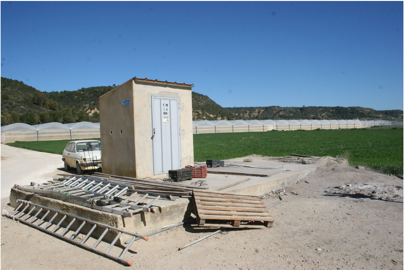
Camera di manovra presa n. 14 bis
