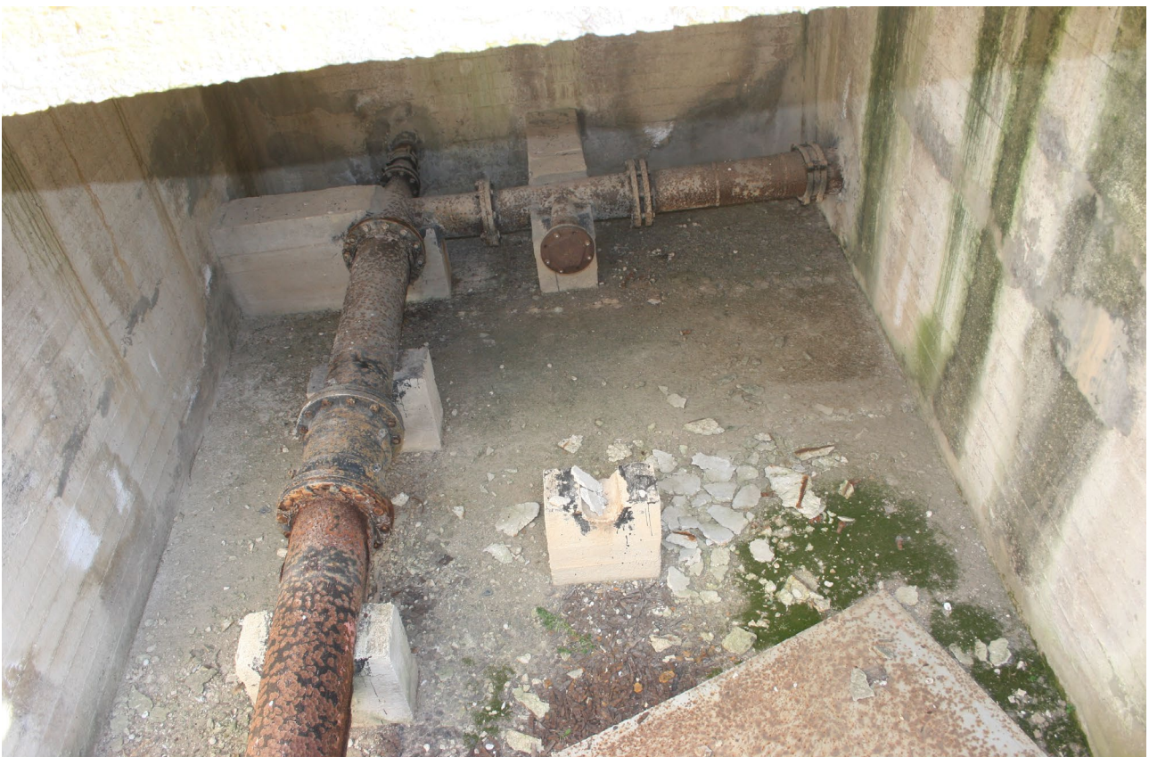
Camera di manovra presa n. 3
