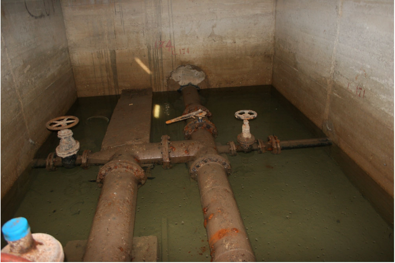
Camera di manovra presa n. 17
