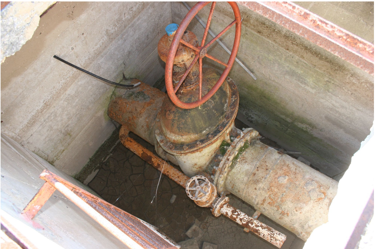
Vasca di disconnessione 4 - Camera di manovra
