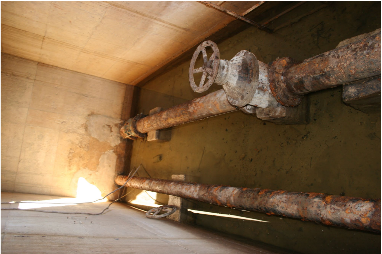
Camera di manovra presa n. 10
