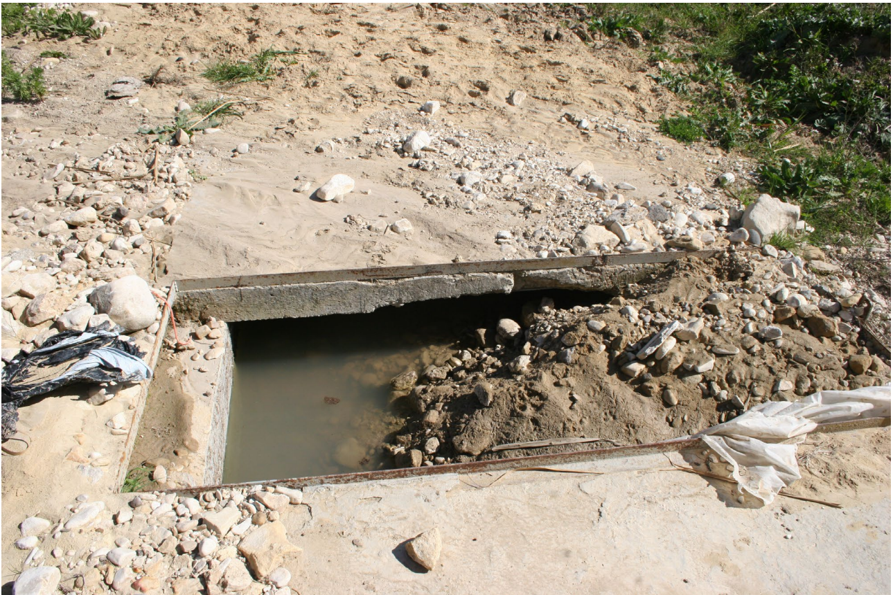
Camera di manovra presa n. 5
