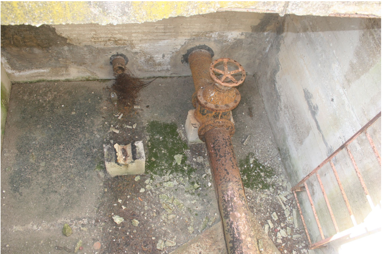
Camera di manovra presa n. 3
