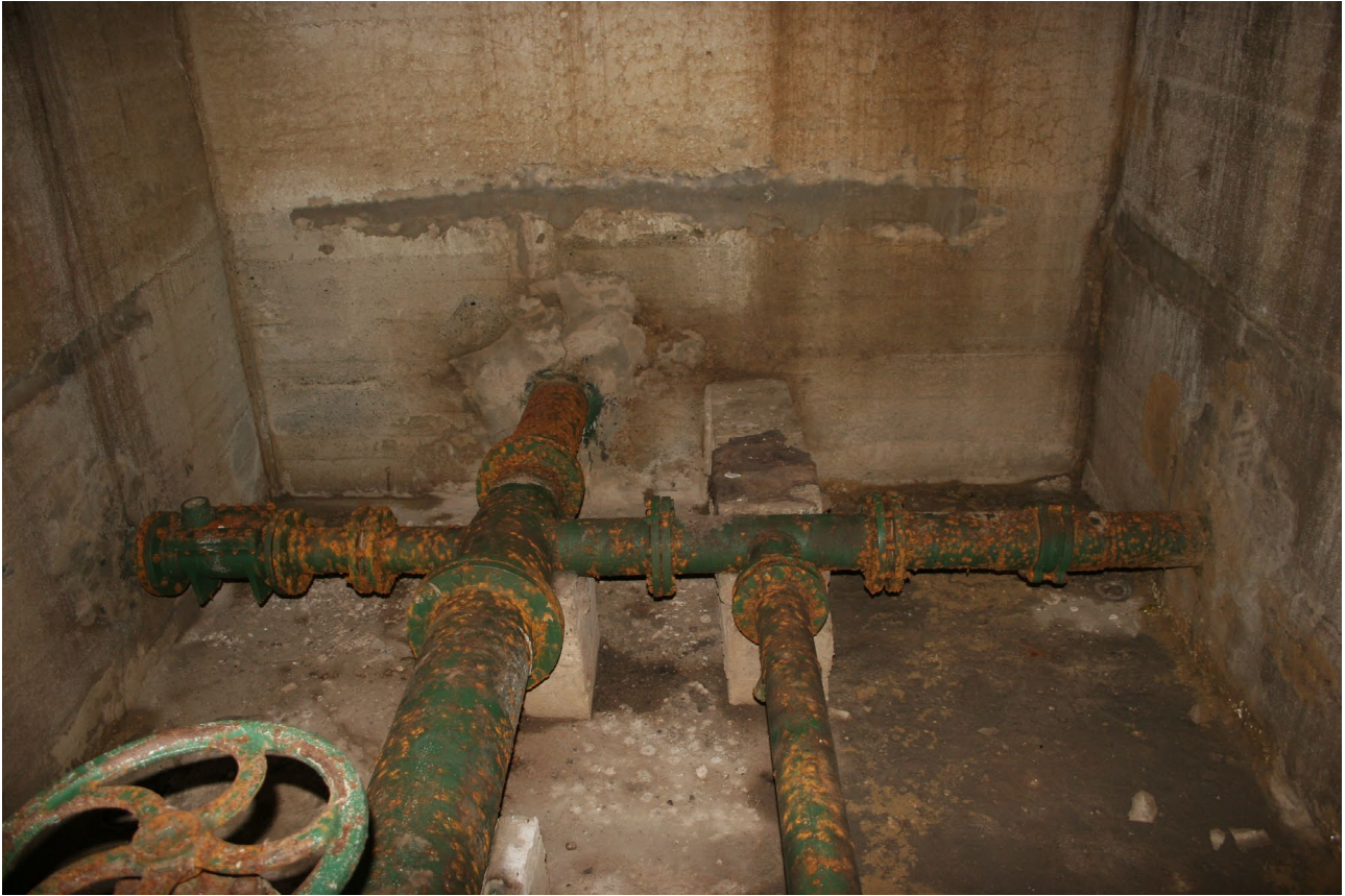
Camera di manovra presa n. 15
