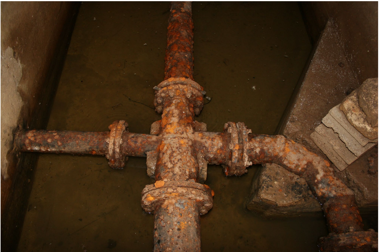
Camera di manovra presa n. 10
