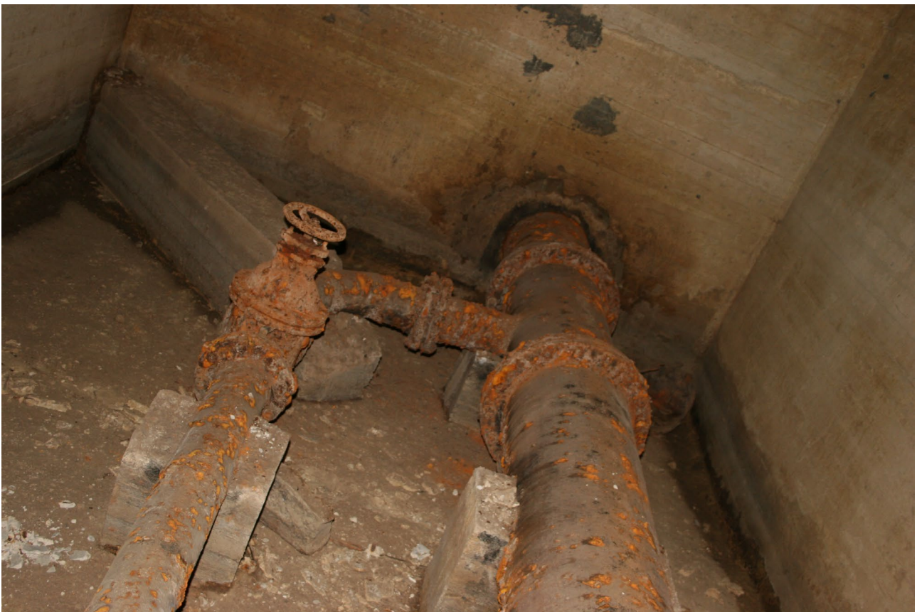
Camera di manovra presa n. 12
