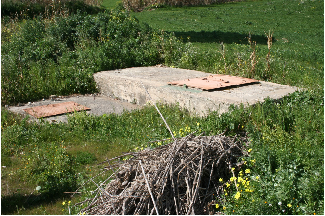
Camera di manovra presa n. 6
