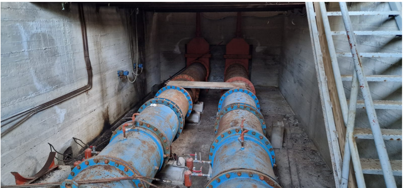
Camera di manovra presa diga Ragoletto - Foto n. 6
