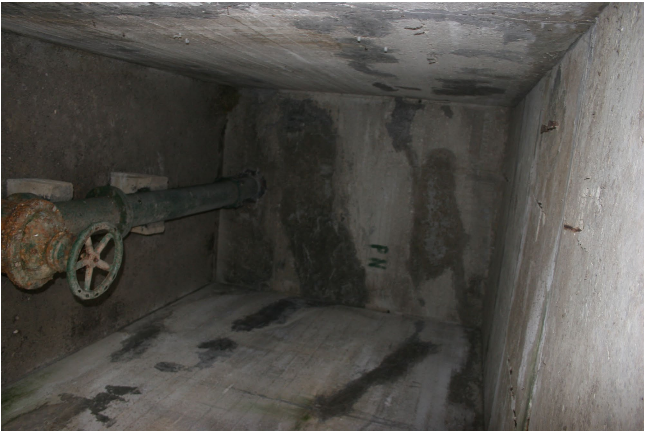
Camera di manovra presa n. 4
