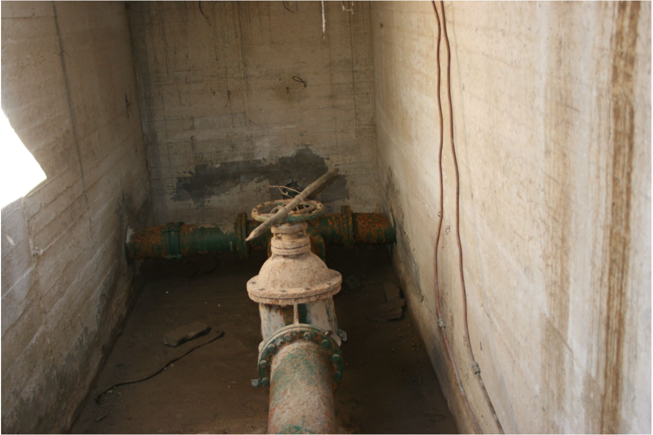
Camera di manovra presa n. 16
