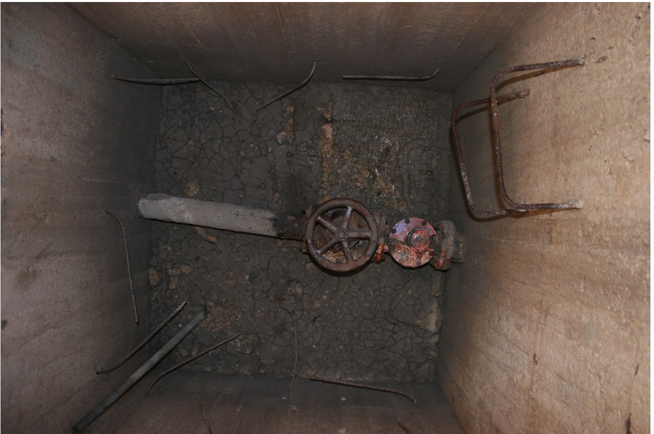
Camera di manovra presa n. 8-9
