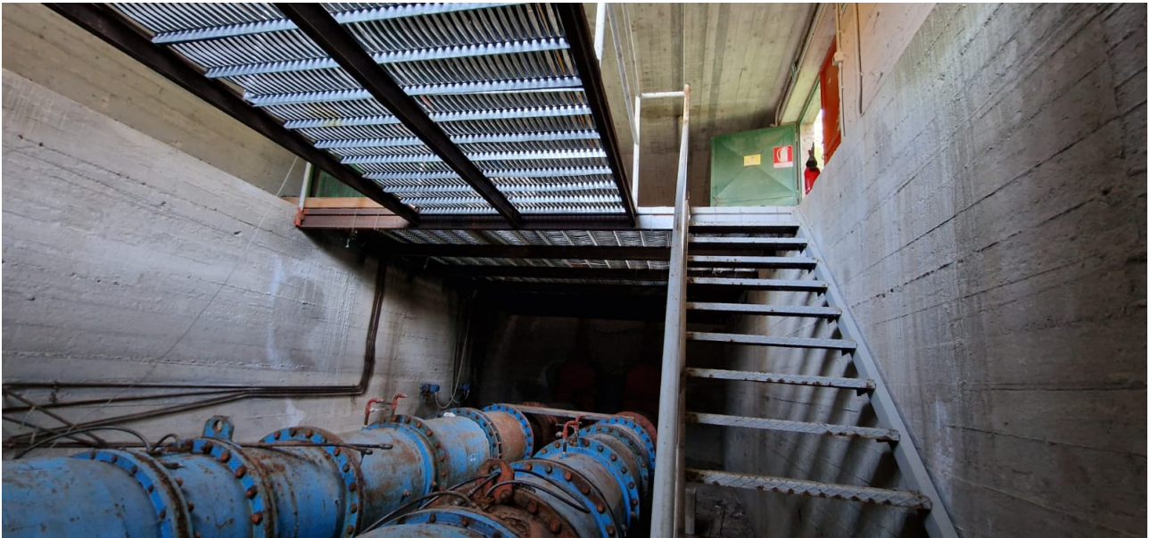
Camera di manovra presa diga Ragoletto - Foto n. 7
