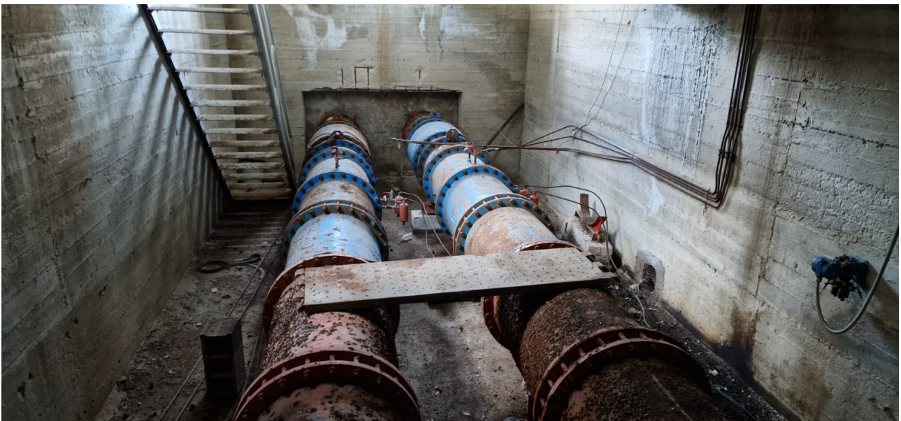
Camera di manovra presa diga Ragoletto - Foto n. 8
