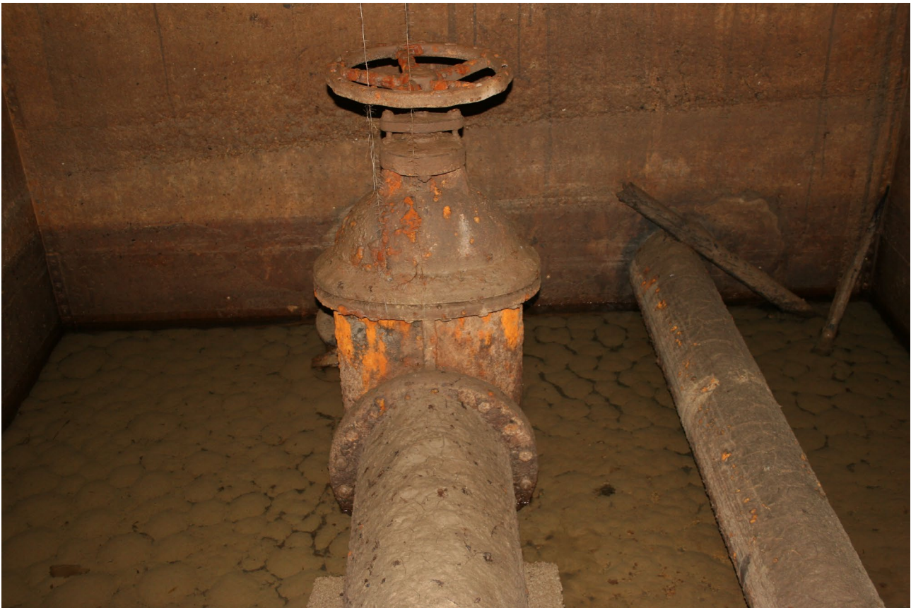
Camera di manovra presa n. 13-14
