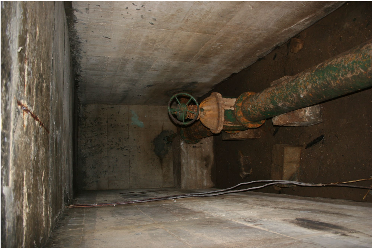
Camera di manovra presa n. 7
