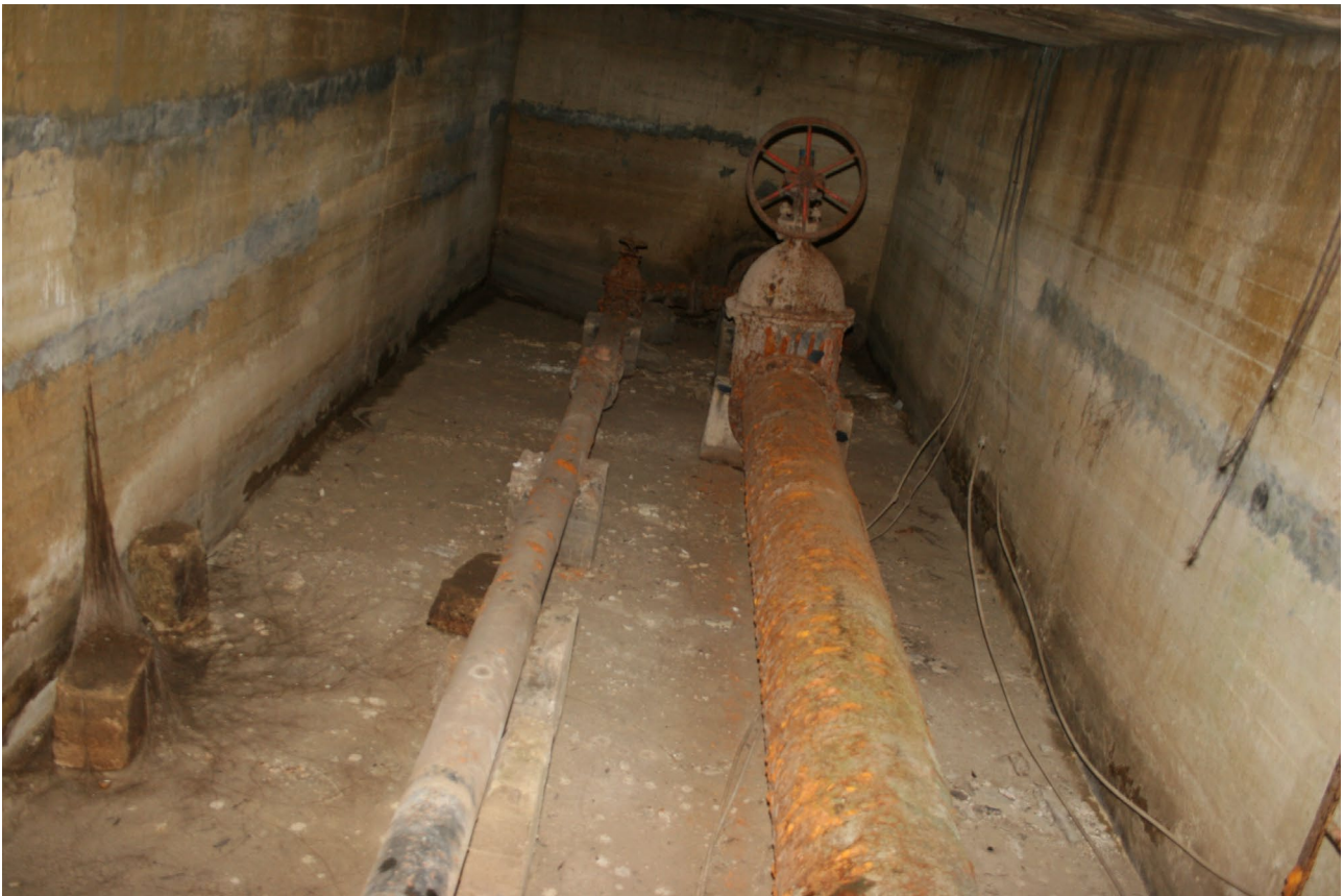
Camera di manovra presa n. 12
