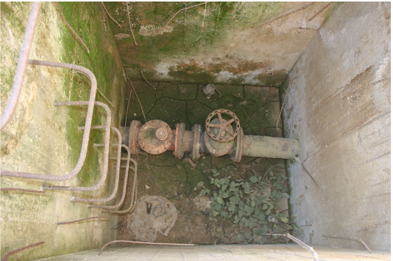
Camera di manovra presa n. 11
