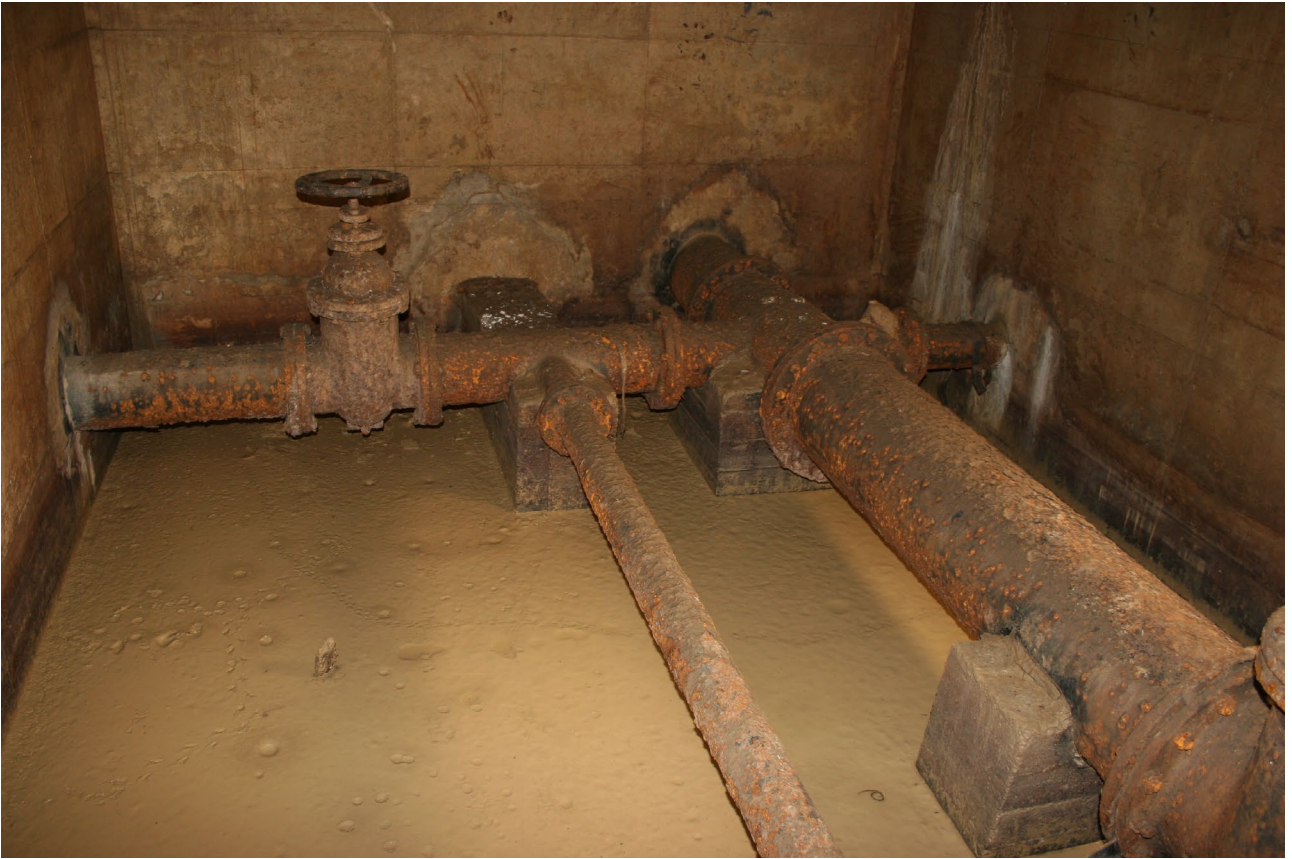
Camera di manovra presa n. 11
